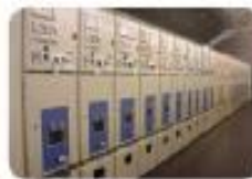
中壓主配電盤
